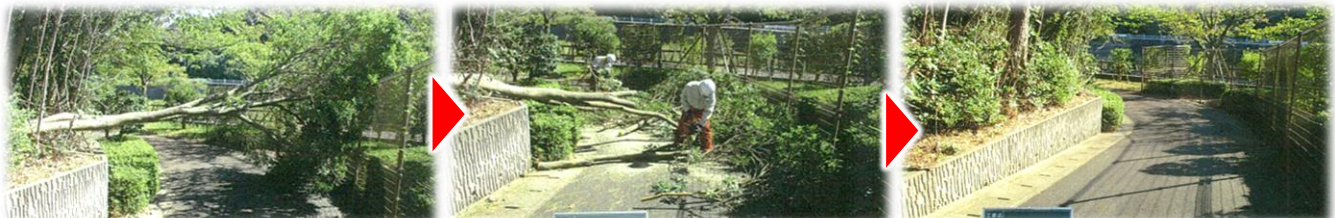
台風17号災害状況（着工前）
