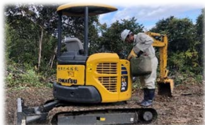
燃料漏れが発生！（想定）
