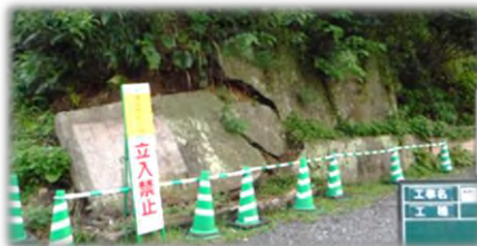
豪雨による法面崩壊（着工前）
